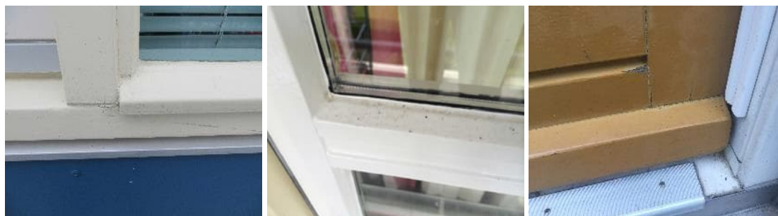
Foto 1: Lichte verschade bij verbindingen en kitvoegen
